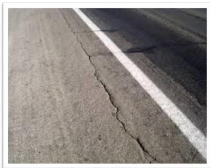
شکل ۵- ترک طولی و عرضی
